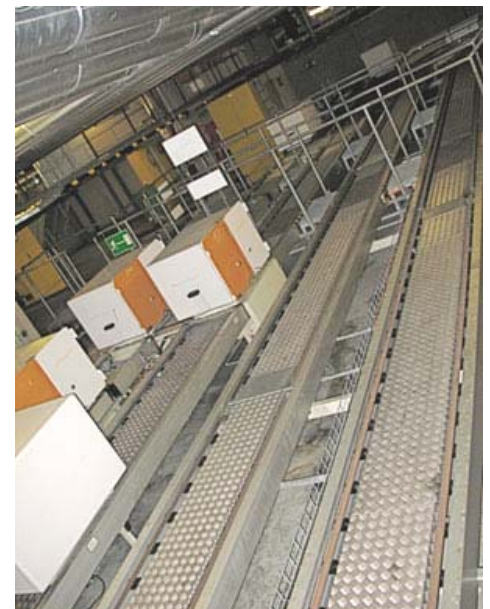
Die Transportanlage im Inneren des Wiener AKH (Foto: Hutter)
